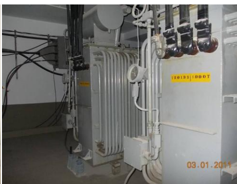
Figura 1.6 – equipamentos no interior da subestação
