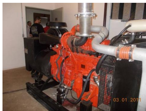
Figura 1.34 – grupo motor gerador utilizado para suprir cargas essenciais
