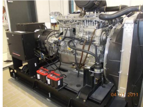
Figura 1.15 – grupo motor gerador
