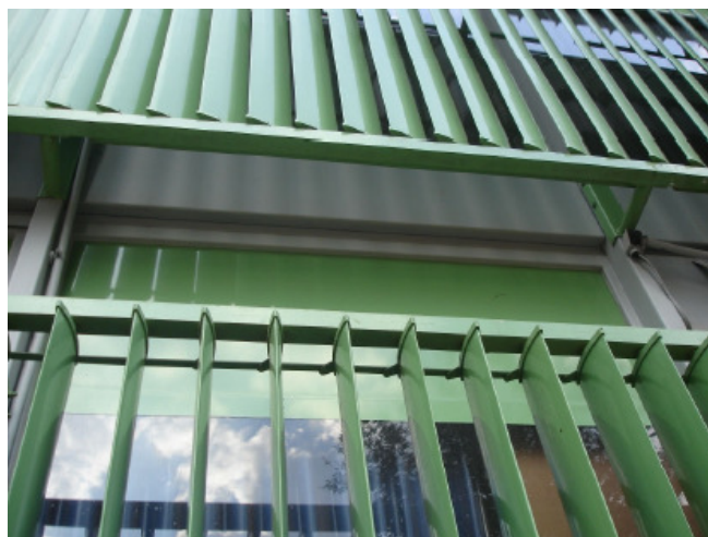
Figura 5 – Brises verticais instalados na fachada Oeste.
