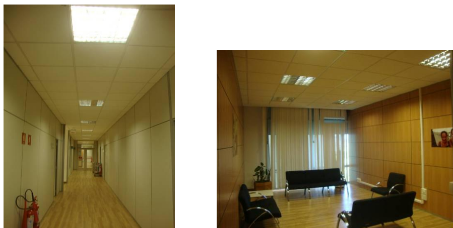
Figura 1.13 – equipamentos do sistema de iluminação do Ministério de Desenvolvimento Social e Combate a Fome
