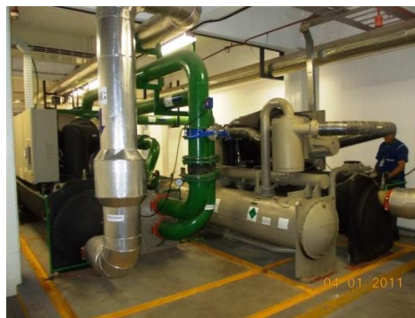
Figura 1.23 – equipamento de climatização atual dos prédios dos anexos
