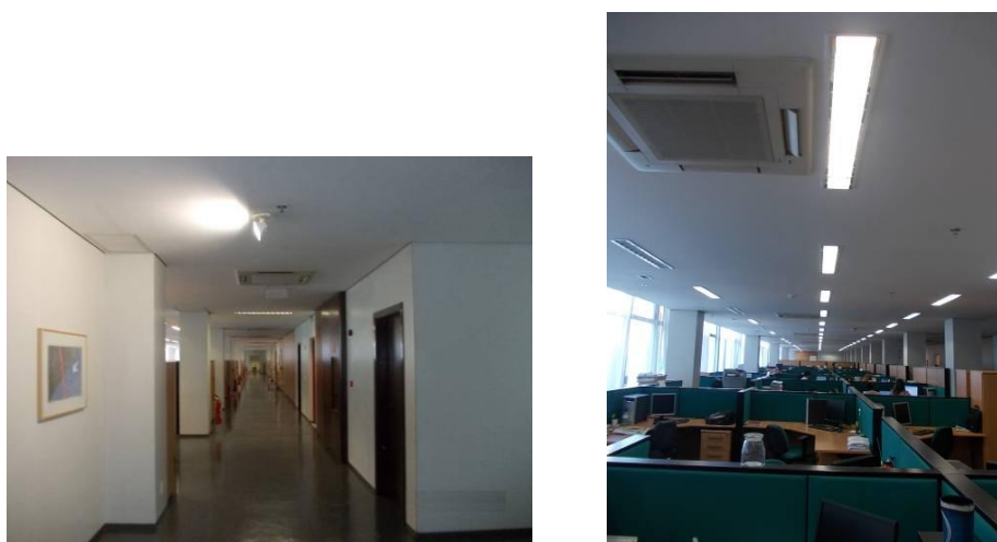
Figura 1.19 – equipamentos do sistema de iluminação do Ministério da Cultura
