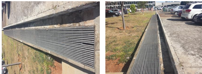
Grelhas de ventilação da Garagem
