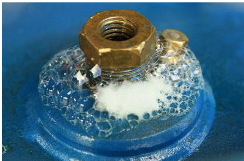
FIGURA 3 – VAZAMENTO DO GÁS NA ROSCA DA VÁLVULA
