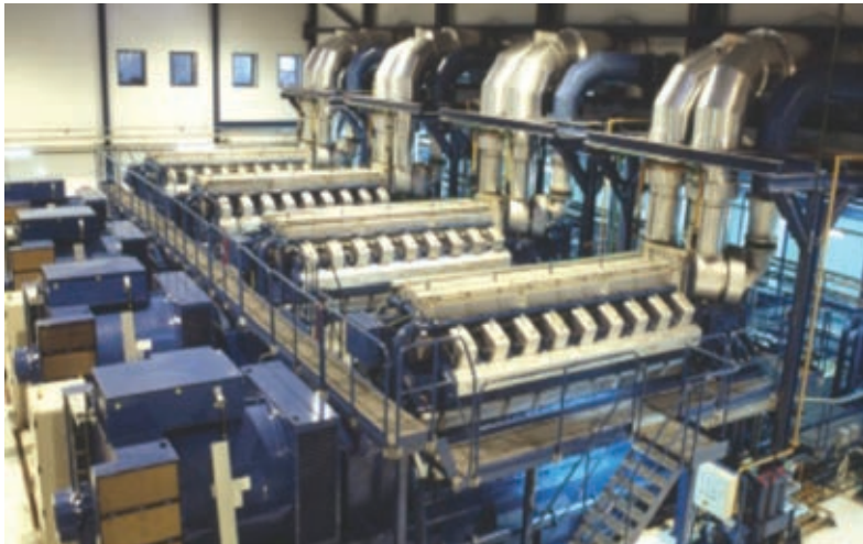
Figura 6 – Instalação com múltiplos motores para geração de energia elétrica
