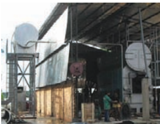
Figura 11.13 – Casa da Caldeira e tanque de condensado
