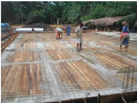
Figura 11.7 – Detalhes da construção da laje da usina de geração de energia elétrica
