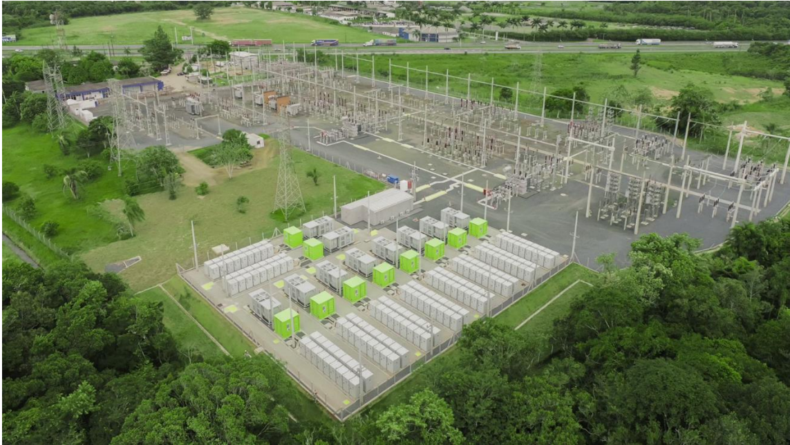
Figura 2 Foto aérea do maior sistema de armazenamento de energia em baterias do Brasil
