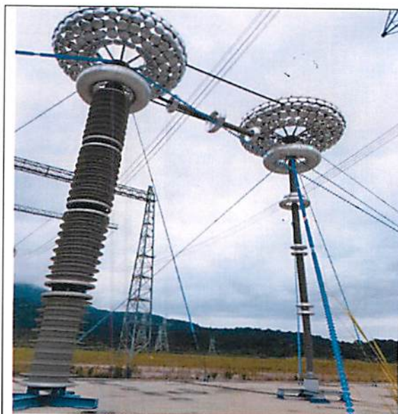
Toróides superior 1600 kV DC e suportes de armazenamento
