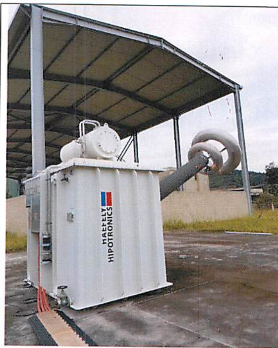
Transformador de Alta Tensão (Vista Lateral) e galpão metálico à esquerda (Cepel Adrianópolis - Nova Iguaçu - 05/06/2018)
